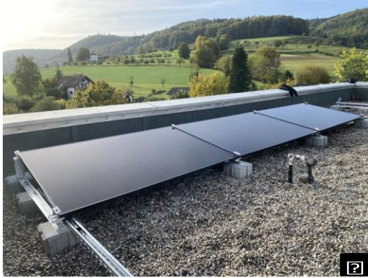
PV-Anlage Hochbau Sek Gelterkinden
