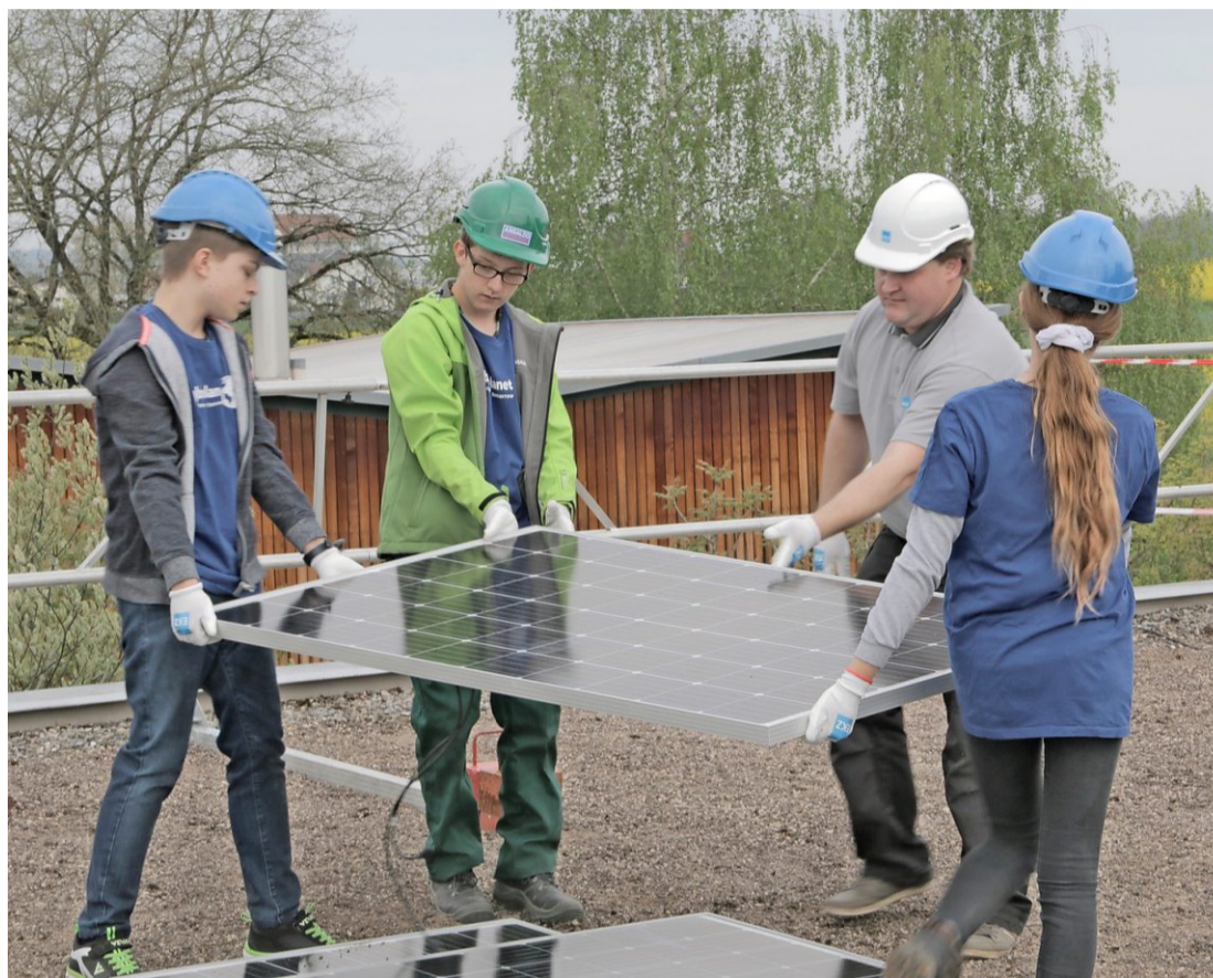
Während der Projektwoche halfen die Schülerinnen und Schüler beim Aufbau der Solaranlage mit. Foto: PD
