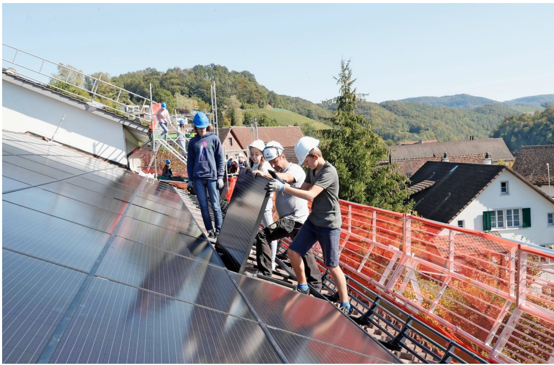
Unter Anleitung von Gaetano Senn (2. von rechts) befestigen Taj, Jade und Manuel (von links) die Solarmodule auf dem Schuldach.
