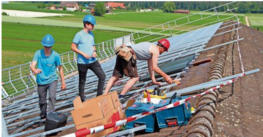
Das Montieren und das Begehen des Schulhausdaches fanden alle Schülerinnen und Schüler der Sek Andelfingen spannend. Wie der Strom vom Dach in die Steckdose kommen wird, eher weniger.
