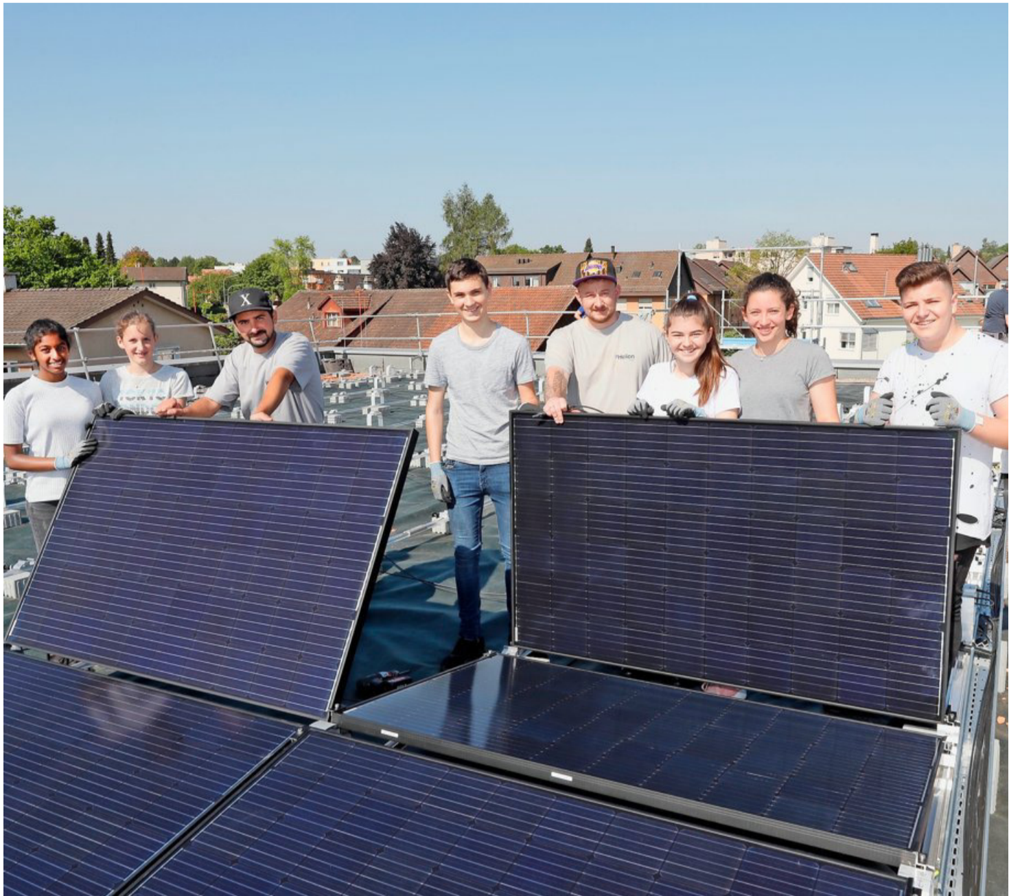
Dietliker Schüler und Schülerinnen helfen den Monteuren, die Fotovoltaikanlage auf dem Schulhausdach anzubringen.
